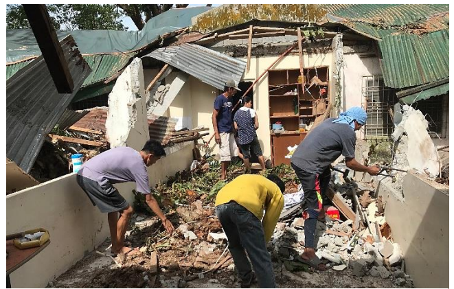
損壊したセンター（ダイニングを含む建物）の様子 （12月23日）
